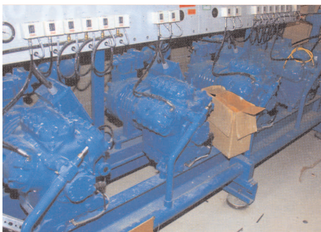
La centrale positive se compose de quatre compresseurs délivrant 250 kW (- 11 °C à 45 °C). La centrale négative comprend trois compresseurs totalisant 40 kW (- 37 °C à 45 °C). Le local insonorisé (BA 13) est climatisé à 28 °C par un évaporateur double flux basse vitesse.
